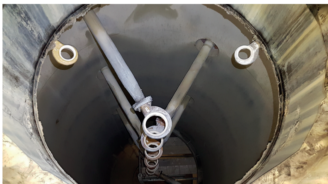
Intérieur du laveur des fumées G1
