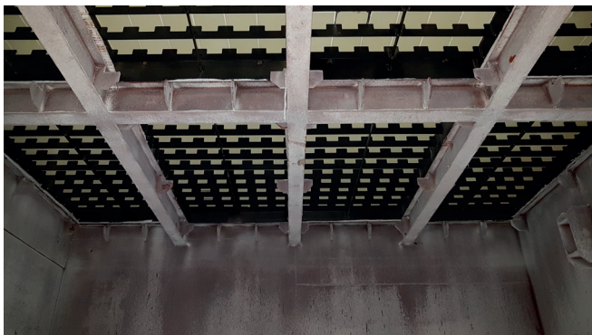
plafond du catalyseur de la DeNOx
