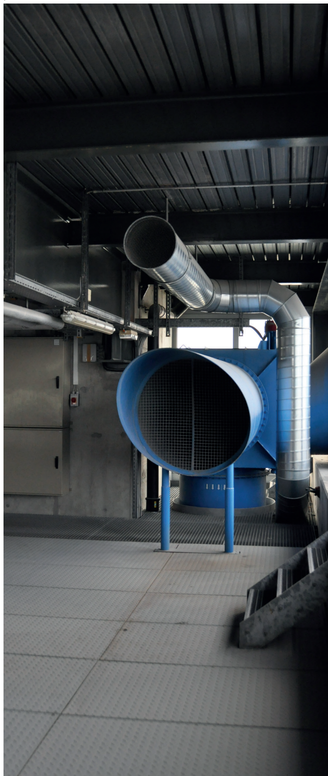
prise d'air de combustion UIOM
