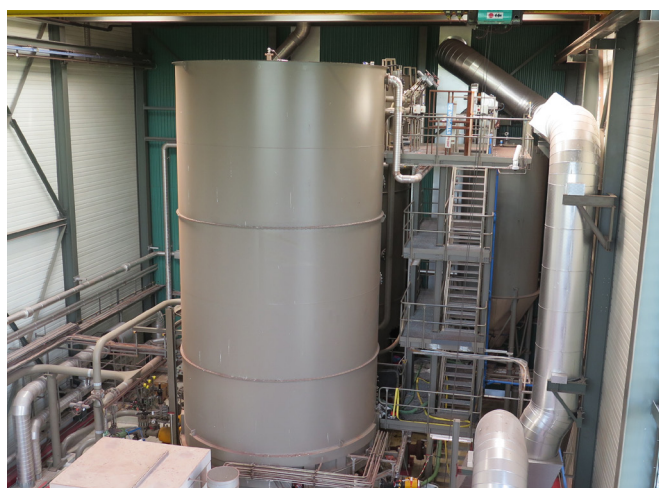
Silo de stockage des boues
